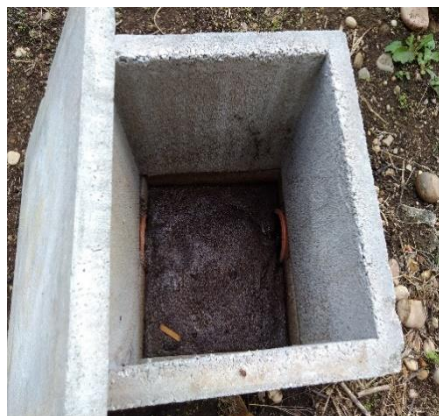
Figura 3.2 – Caixa exterior recetora das águas de lavagens do pavilhão.
