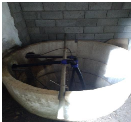
Figura 2.4 – Bomba de extração de água da captação subterrânea.
