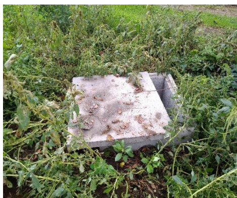
Figura 3.3 – Caixa de receção dos chorumes provenientes dos Pavilhões A e B através das fossas existentes à saída dos respetivos pavilhões.
