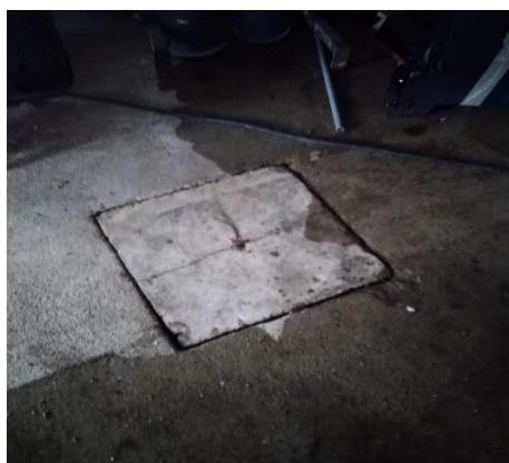
Figura 3.1 – Encaminhamento águas residuais resultantes das lavagens dos pavilhões (chorume) para a caixa recetora.
